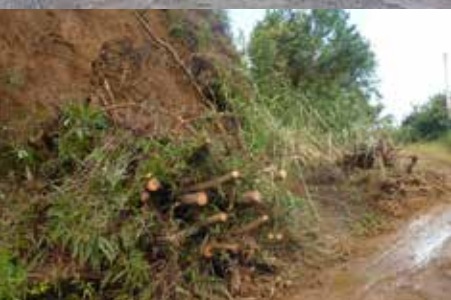
Rue Adénor Payet - Éboulis
